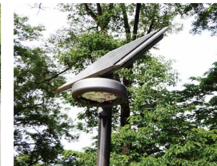
▲敷地内ソーラー街灯
